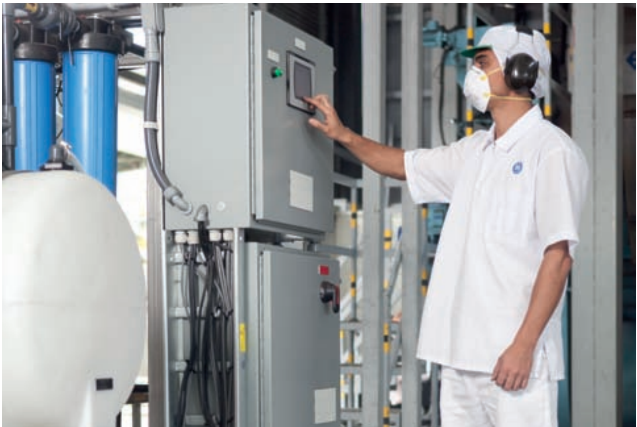
Reverse – osmosis equipment, the Compañía Nacional de Chocolates Plant; Rionegro, Colombia.
