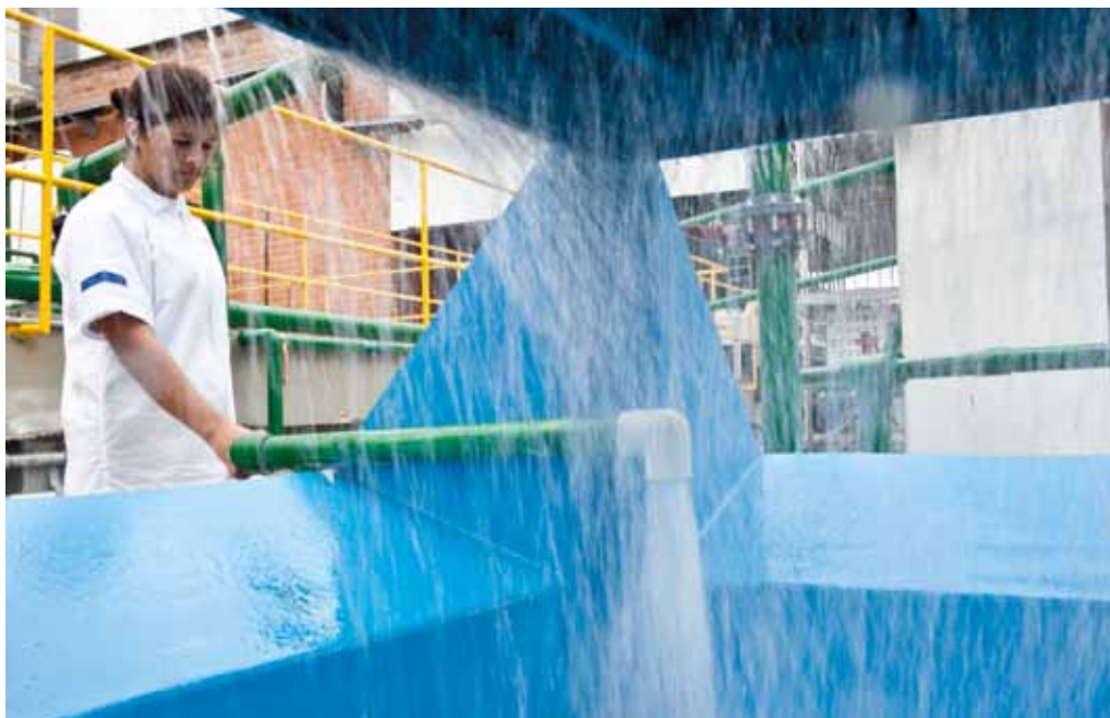
Planta de tratamiento de agua potable. Alimentos Cárnicos, La Ceja, Colombia.
