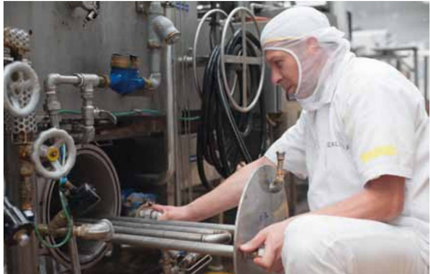
Serpentines de calentamiento en tanque de desmoldeo. Planta Meals, Bogotá, Colombia.
