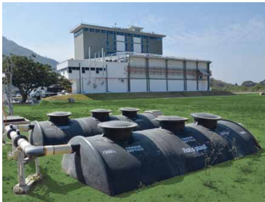
Planta de tratamiento de aguas residuales. Molino Santa Marta, Santa Marta, Colombia.
