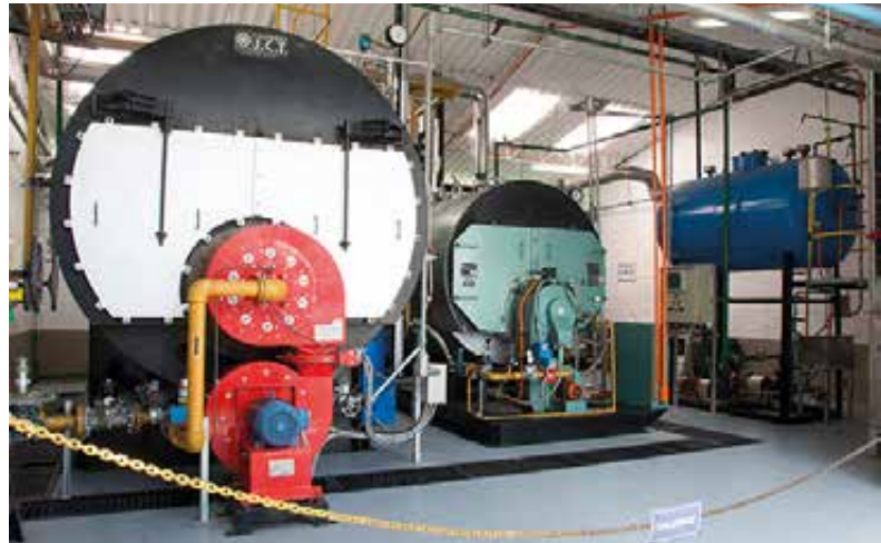
Cambio de combustibles en calderas. Planta Cárnicos Nutresa, La Ceja.
