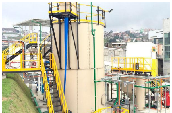
Planta de tratamiento de aguas residuales. Planta Bogotá Negocio Cárnico, Colombia.
