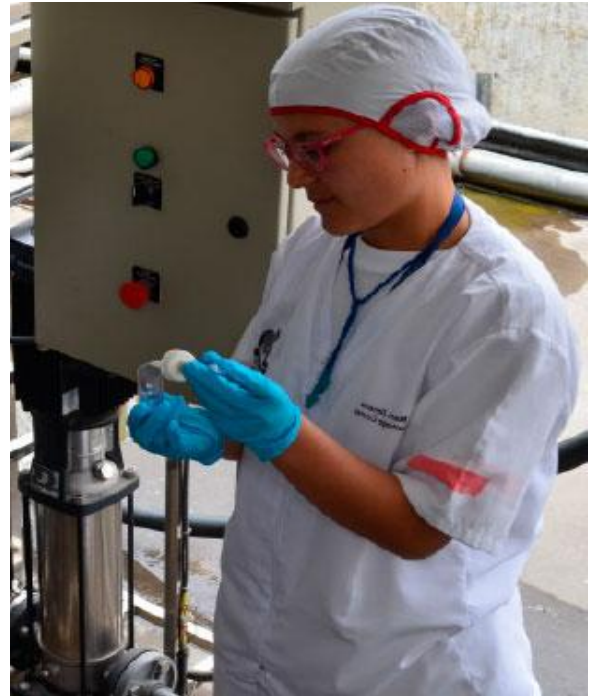
Sistema de tratamiento de agua recuperada para servicios industriales, Pastas Doria. Mosquera, Colombia.
