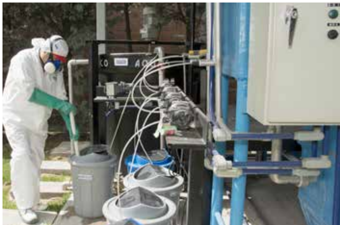
Operario de la planta de tratamiento de aguas residuales del Negocio Café, Medellín.
