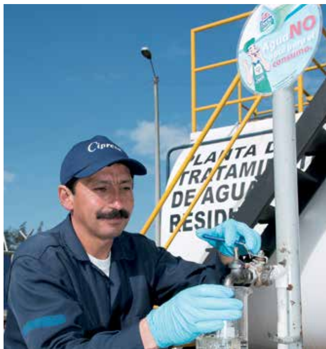
Planta de tratamiento de aguas residuales del Negocio Pastas en Mosquera, Cundinamarca.
