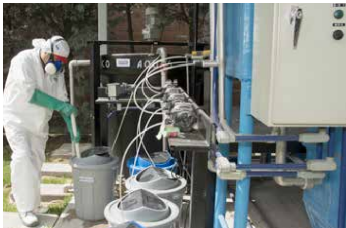
Operario de la planta de tratamiento de aguas residuales del Negocio Café, Medellín.
