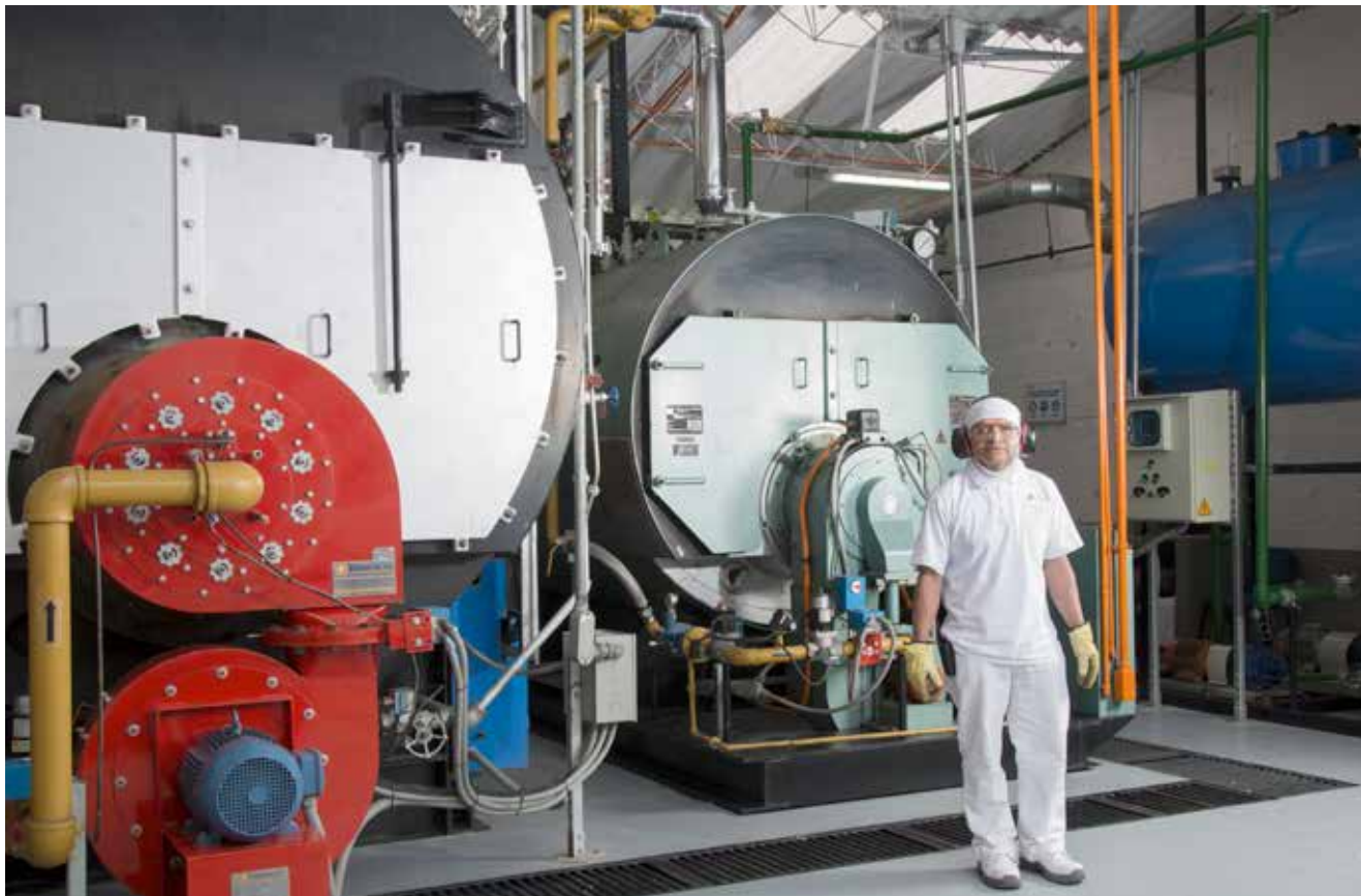
Operario de calderas en la planta del Negocio Cárnicos en Bello, Antioquia.
