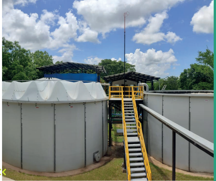
Planta de tratamiento de aguas, Negocio Cárnicos, Aguachica, Colombia. <<<
